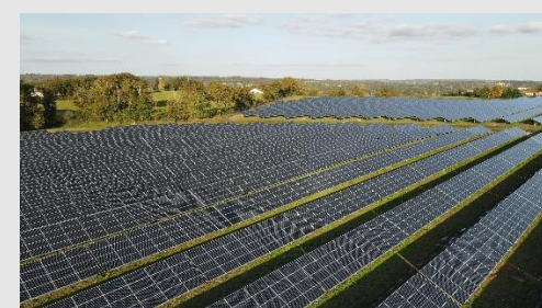
Centrale Solaire d'EXIDEUIL Département : Charente (16) Puissance électrique : 9600 kWc Mise en service : Décembre 2020
